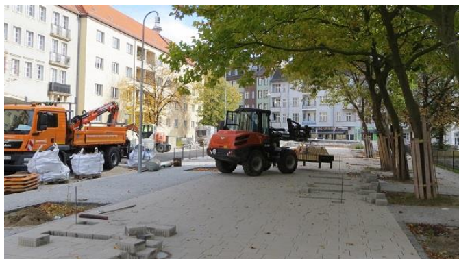
Die Promenade am Roedeliusplatz ist bald fertig. Links die Pflanzgruben für eine zusätzliche Baumreihe
